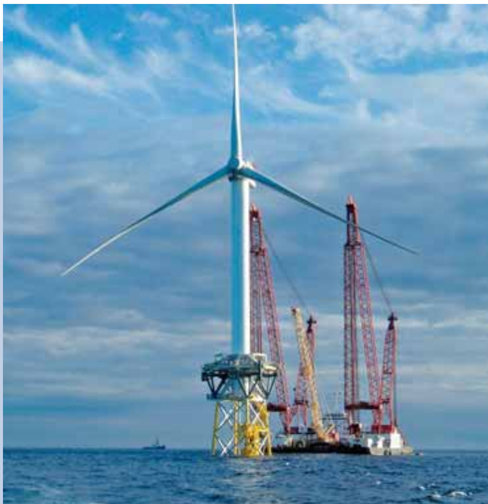
↑ 5-Megawatt-Windrad vor der schottischen Küste. Der Rotordurchmesser beträgt 126 m. Ähnlich große Windräder werden zurzeit vor der Küste Borkums in Stellung gebracht. Dort entsteht unter dem Namen „alpha ventus“ Deutschlands erster Offshore-Windpark. Bild: REpower Systems
